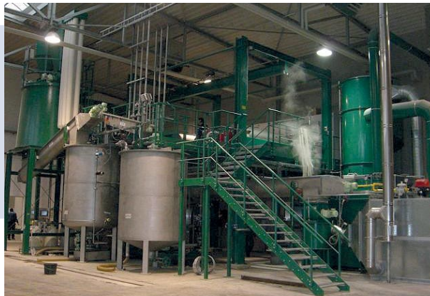
Sistema con SORTICANTER® FLOTTWEG per il recupero di poliolefine da plastiche miste, installato presso uno stabilimento in Germania
